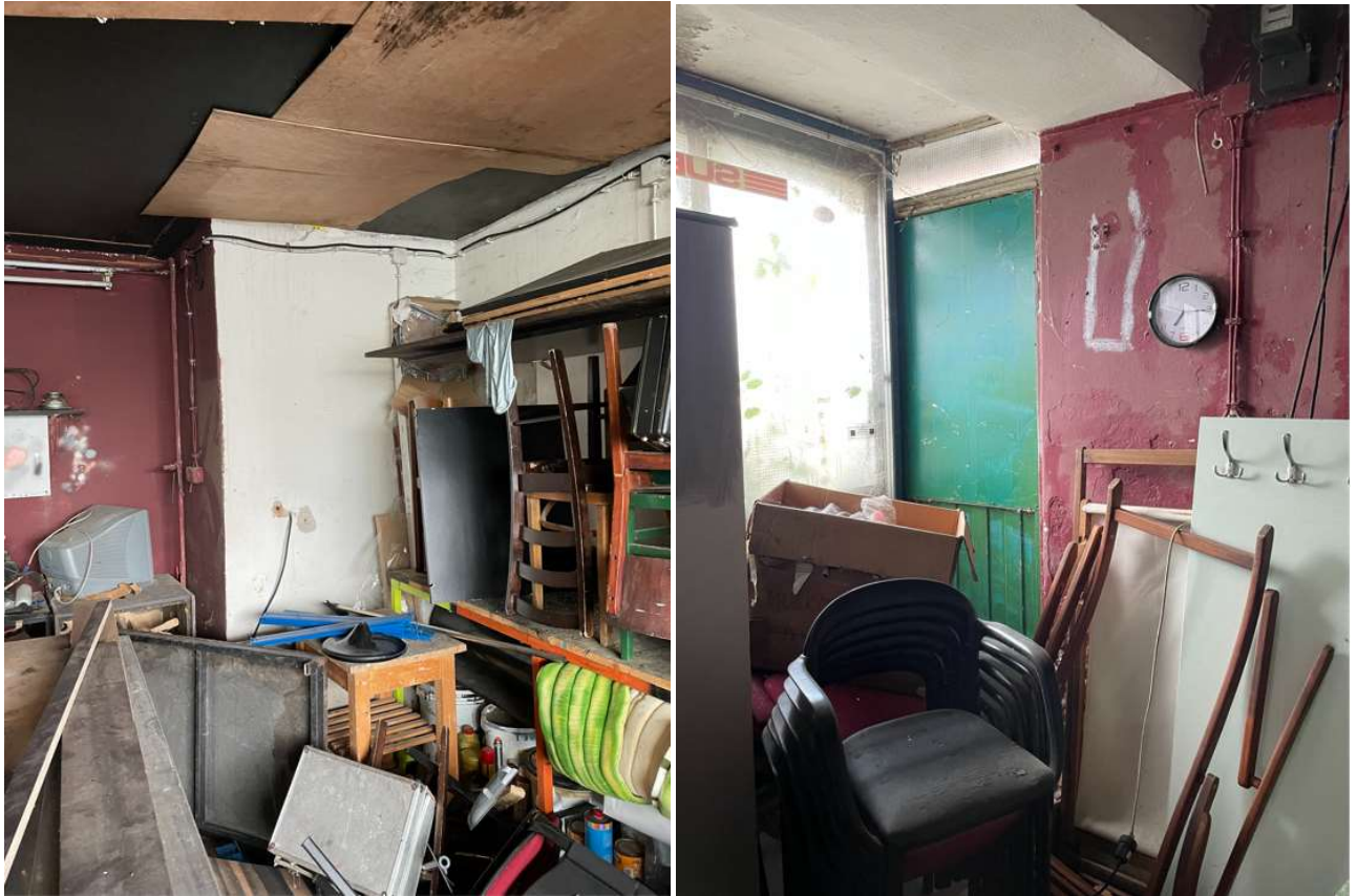
Slika 10. Prizemlje - stropna obloga u lošem stanju + oštećenja od vlage
