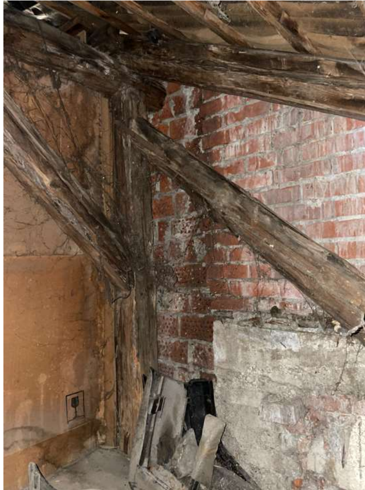
Slika 26. Nosivi elementi krovništva na mjestu urušenog grednika – degradirani od vlage
