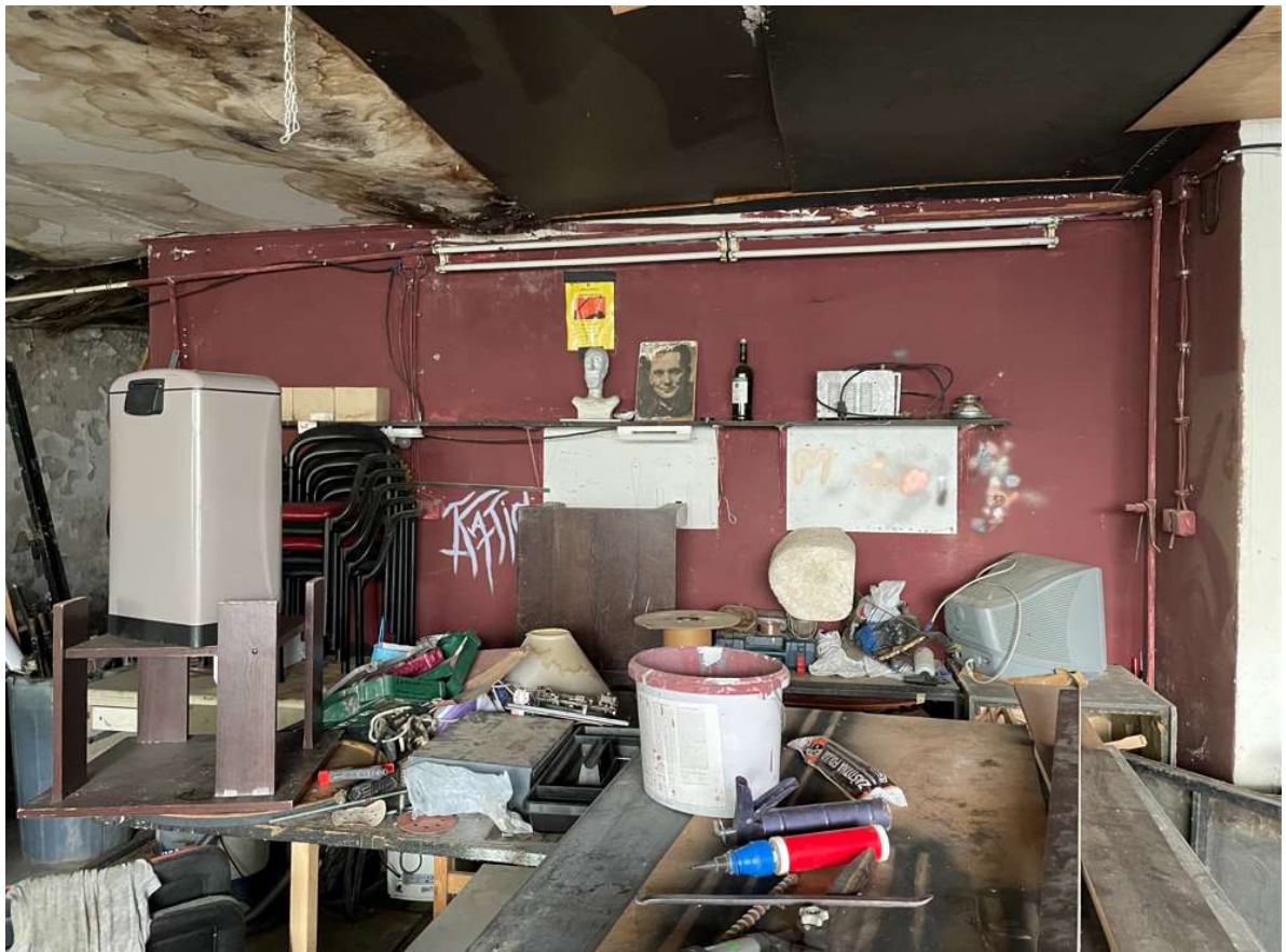
Slika 11. Prizemlje - stropna obloga u lošem stanju + oštećenja od vlage
