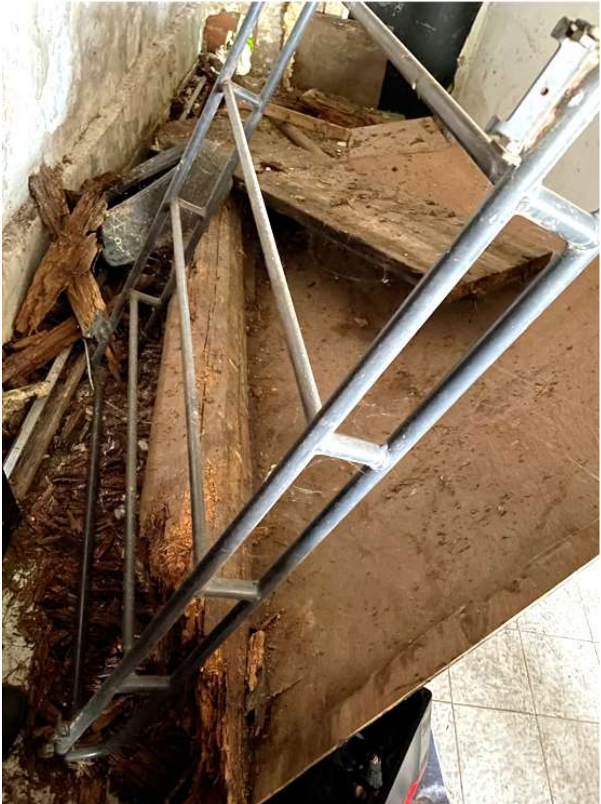
Slika 14. Urušeni drveni gređnik
