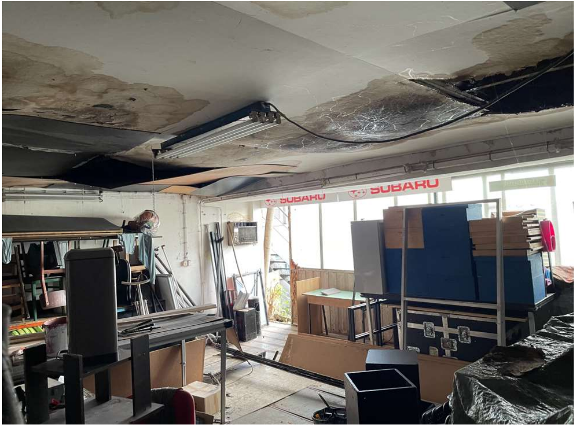
Slika 8. Prizemlje - stropna obloga u lošem stanju
