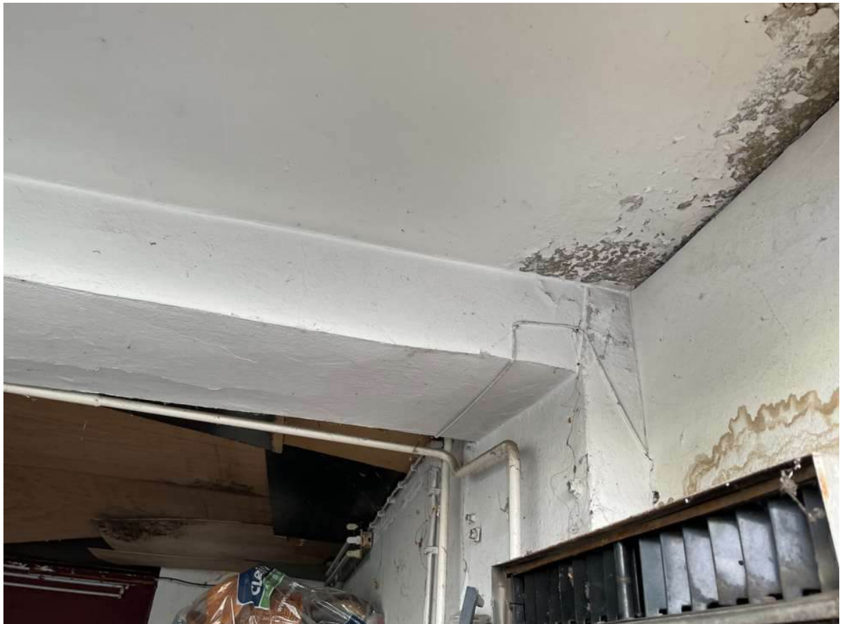
Slika 16. Oštećenja od vlage
