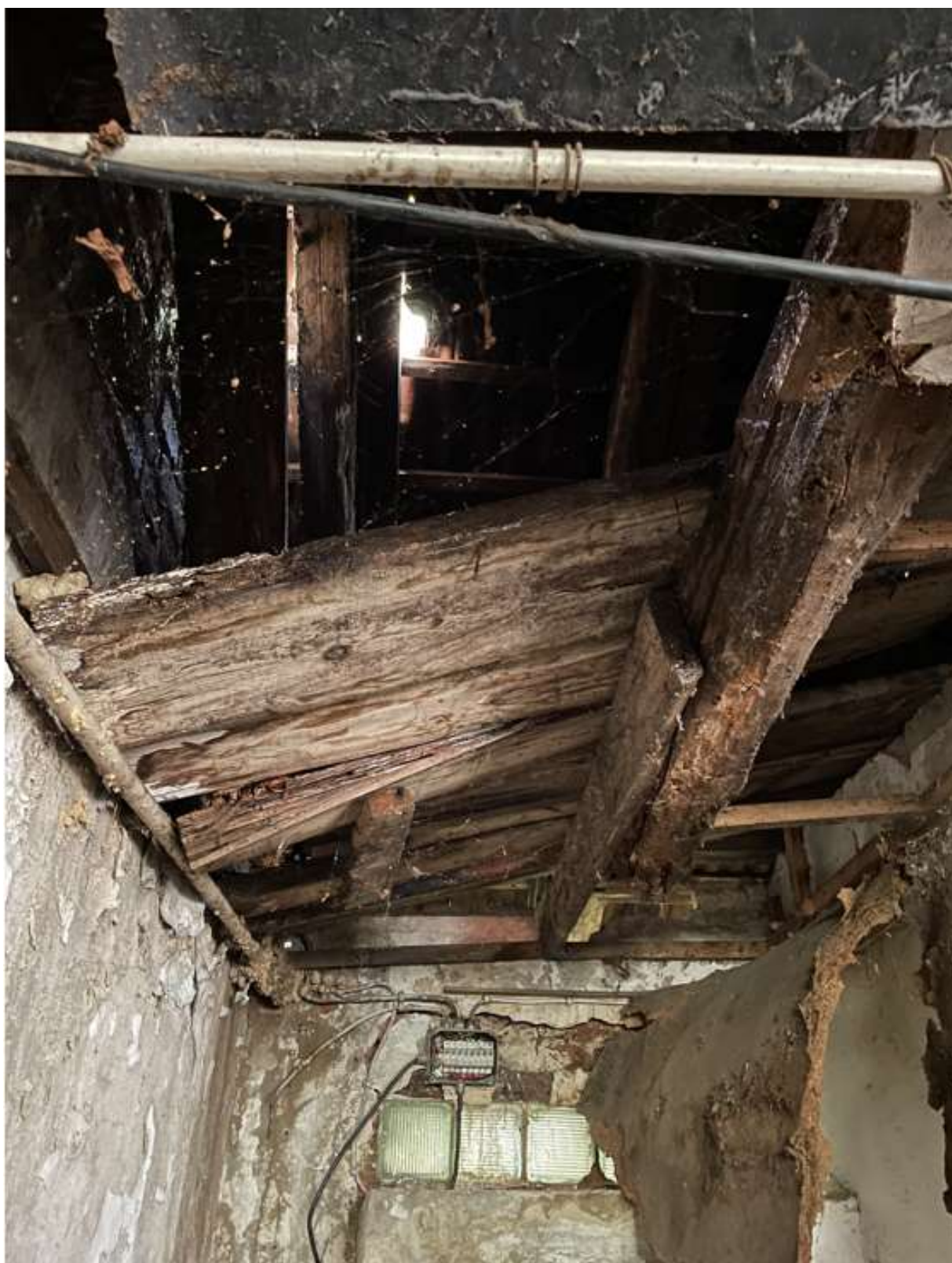
Slika 13. Urušavanje drvenih grednika + oštećeni vrh zida
