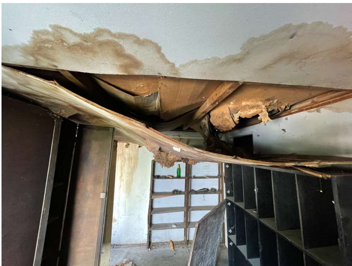
Slika 29. Oštećenja katonske obloge
