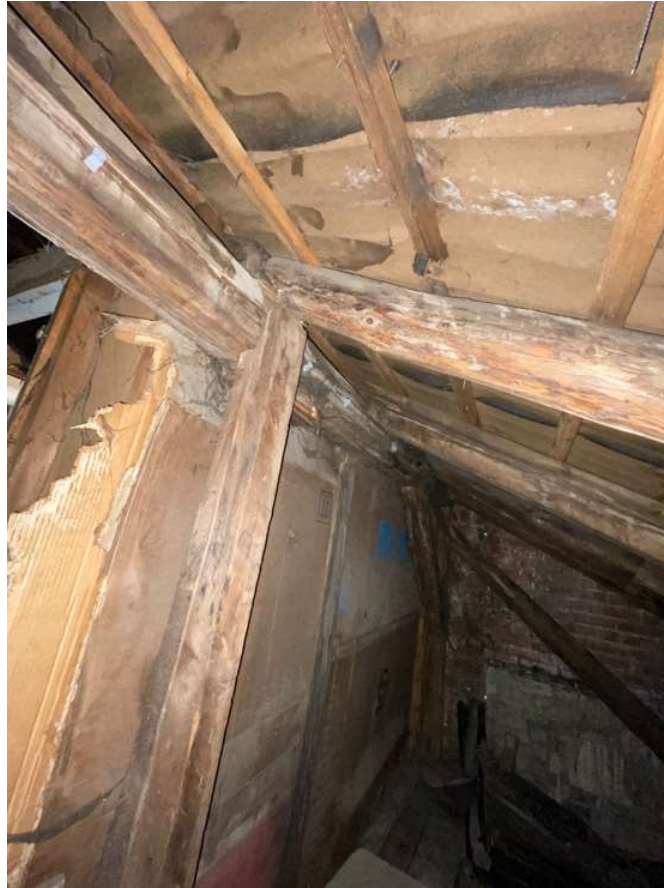
Slika 27. Degradacija krovne obloge
