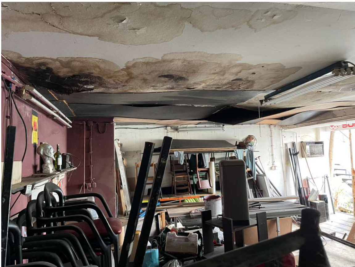
Slika 9. Prizemlje - stropna obloga u lošem stanju
