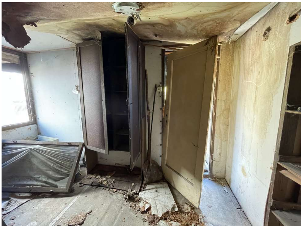
Slika 30. Oštećenja kartonske obloge
