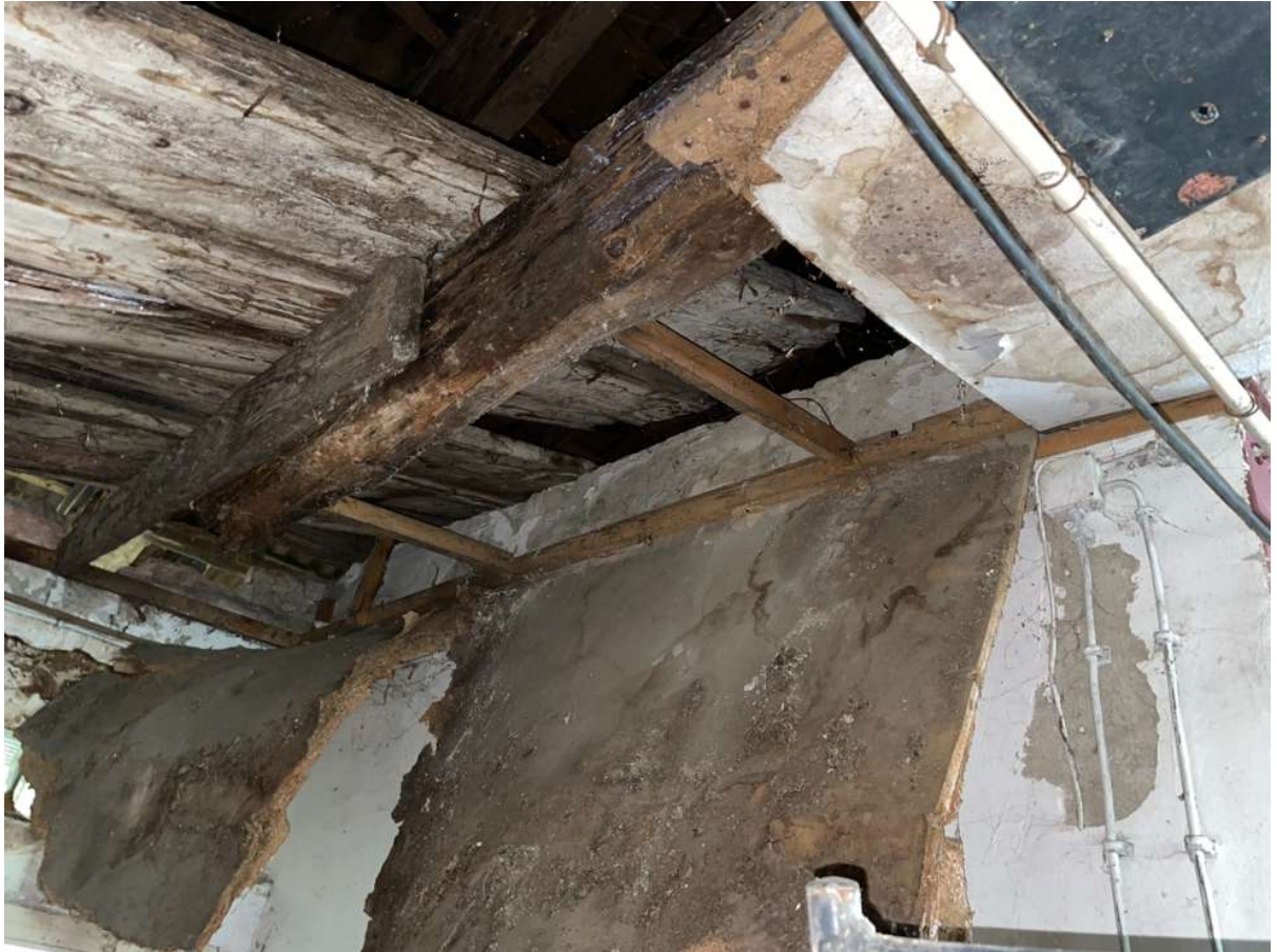
Slika 15. Oštećen drveni grednik - prethodno ojačanje u zoni oslonca
